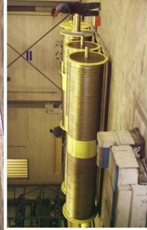
TAMBOUR DE CÂBLE DE L = 4500 mm
